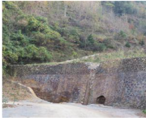
照片 2-30 为渣堆拦渣坝
