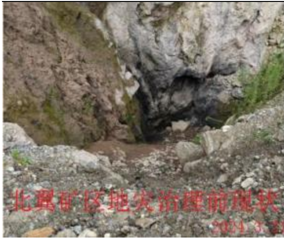
照片2-17为北翼刀背石梁崩塌治理前
