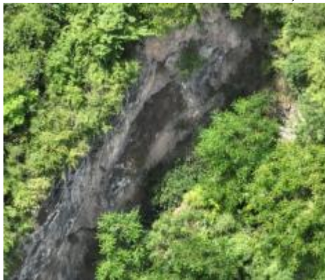
照片3-11为LF5地裂缝（镜像265°）
