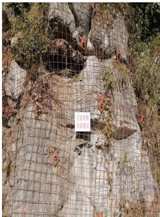
照片 2-17 BT1 崩塌隐患主动防护网及警示标识
